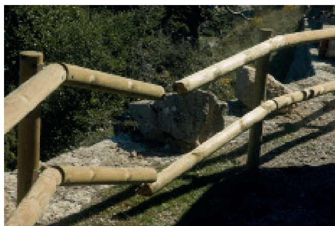
FIGURES 26. Pals de la tanca trencats pel trànsit i gir de vehicles a la pista del santuari (11-X-2007).
